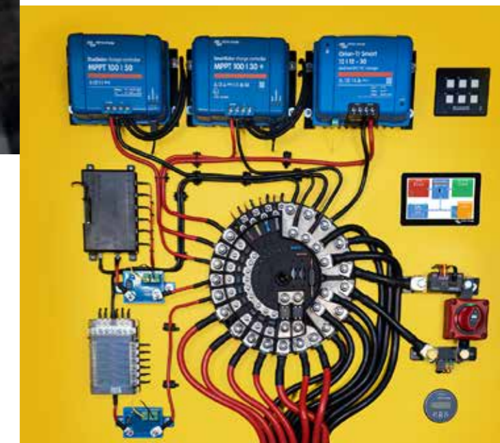
Aufgeräumte Elektroinstallation mit dem neuen TEXU400!
